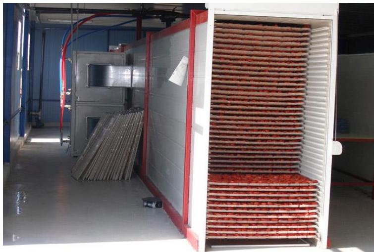
Μονάδα γ/θ αφυδάτωσης ντομάτας στο Ν. Εράσμιο Ξάνθης
